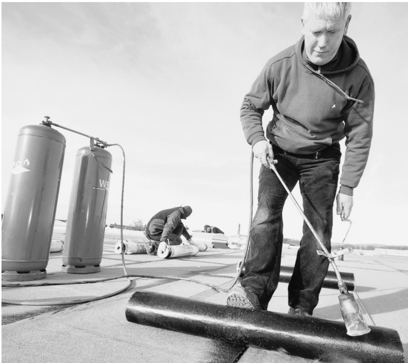
Über den Dächern Bündes: Ein Mitarbeiter des Dachdeckermeister-Betriebes Palsbröcker bei der Arbeit.
